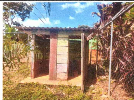
Foto 6: los baños estan totalmente deteriorados.
